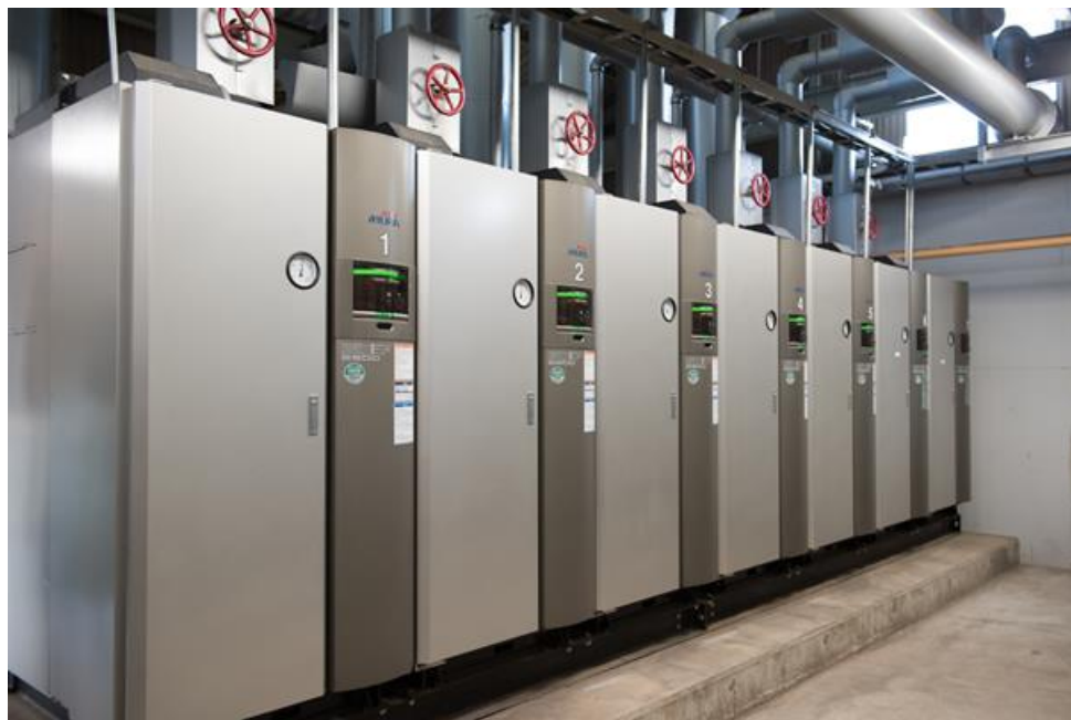
LNGによる蒸気製造(ボイラー)
